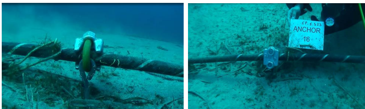
Figure 10 : Autre système de fixation du câble à l'ancre retenu pour le projet (Orange Marine)
